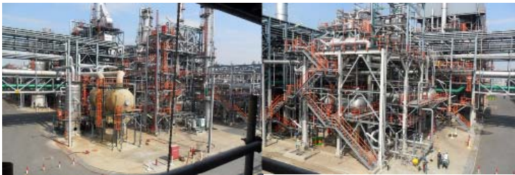
Pipe rack และ Multi-stories
