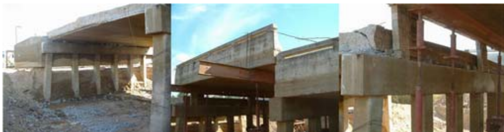
รูปที่ 6 ตัวอย่างระบบโครงสร้างส่วนบน และส่วนล่าง ซึ่งก่อสร้าง และปรับปรุงซ่อมแซมได้สะดวก
