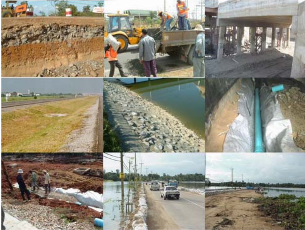
รูปที่ ๑ ตัวอย่างวัสดุโครงสร้างทาง ปรับปรุงทางน้ำ ป้องกันลาด ระบายน้ำใต้ดิน ร่อง หรือคันดักขยะ หรือ ตะกอน
